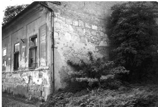
A lepusztult épület 1996-ban
